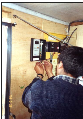
Figura 5.18. Instalação do contador de Ah em uma das instalações fotovoltaicas de Los Uros. [Foto: F. Morante, 28/02/2001]
