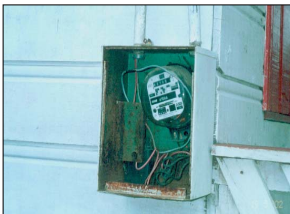
Figura 3.10. Caixa de medição corroída pela exposição ao meio ambiente, Bom Jardim, Benjamin Constant, AM. [Foto: F. Morante, 19/05/2002]
