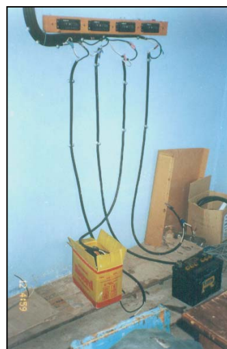
Figura 3.5. Baterias sendo recarregadas por um gerador fotovoltaico sem controlador. Huancho Lima–Puno–Peru [Foto: F. Morante, 12/08/2000]
