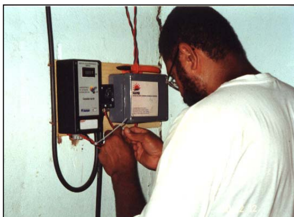
Figura 5.8. Instalação de um contador de Ah na comunidade de Pedra Branca. [FOTO: F. Morante, 12/12/2000]
