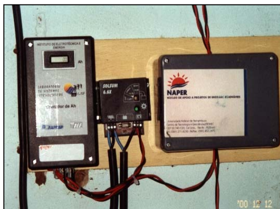
Figura 5.9. Contador e sistema de controle de uma instalação FV de Pedra Branca. [FOTO: F. Morante, 12/12/2000]
