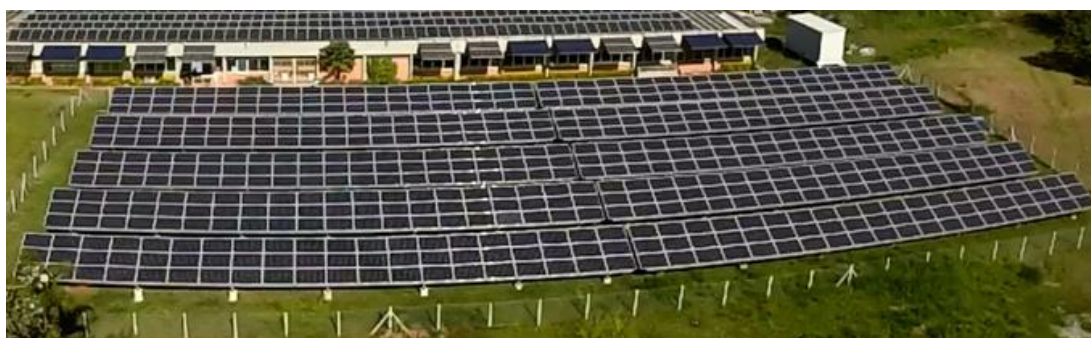
Figura 3.11 - Vista aérea da Usina CTPV IEE/USP.
