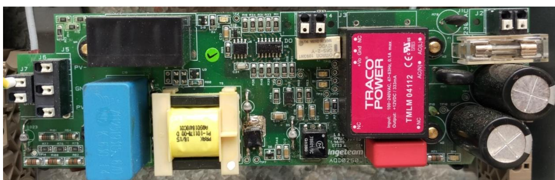
Figura 3.26 - Detalhe do circuito anti-PID adicionado ao inversor
