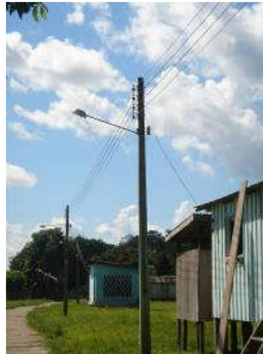
Detalhe da linha de distribuição
