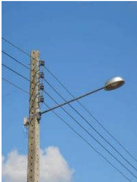
Linha de distribuição
