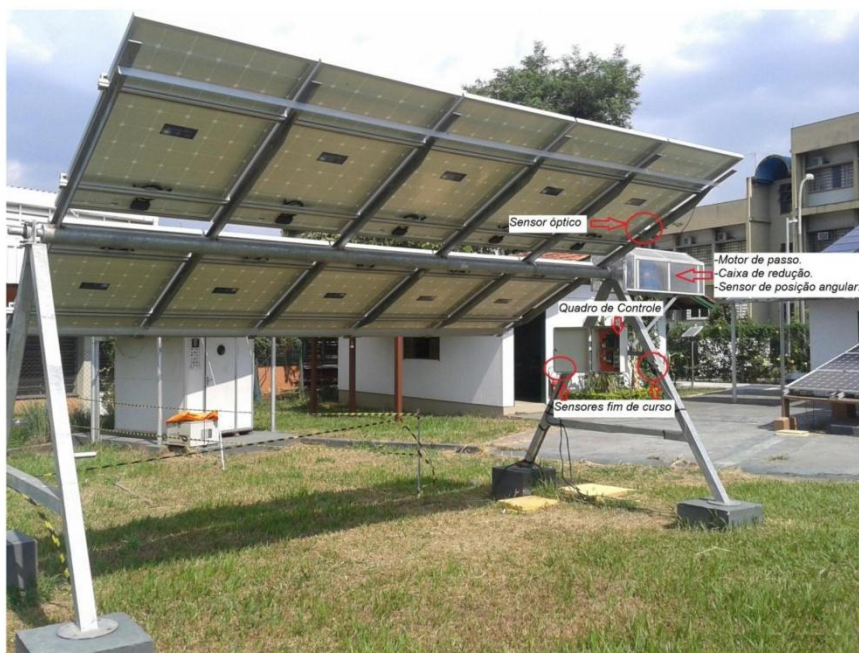
Figura 32. Vista do PSSEH com o sistema de controle instalado.
