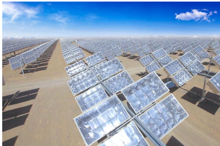
Figura 2.15 - Usina fotovoltaica Golmud de 60 MW, com seguidores tipo roll-tilt , na República Popular da China.
