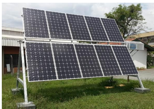
Figura 2.3 - Seguidor solar de um eixo horizontal instalado no LSF/IEE/USP. Fonte: (RODRIGUEZ, ALMEIDA, et al. , 2014)
