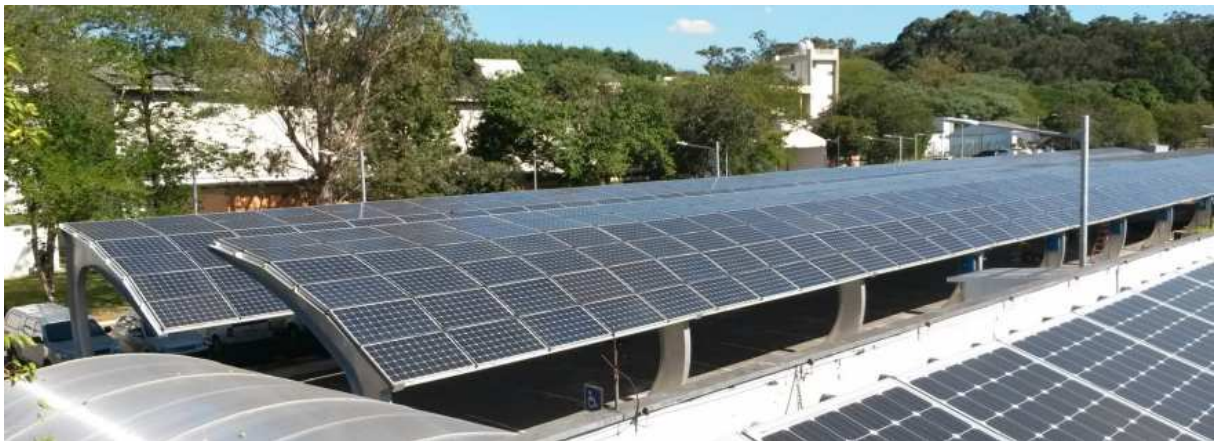
Figura 3.5 - Vista superior do sistema BIPV
