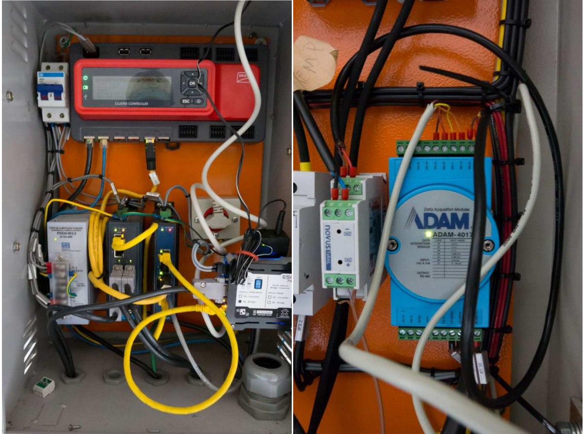
Figura 3.16 - Equipamentos de aquisição e transmissão de dados da usina fotovoltaica.
