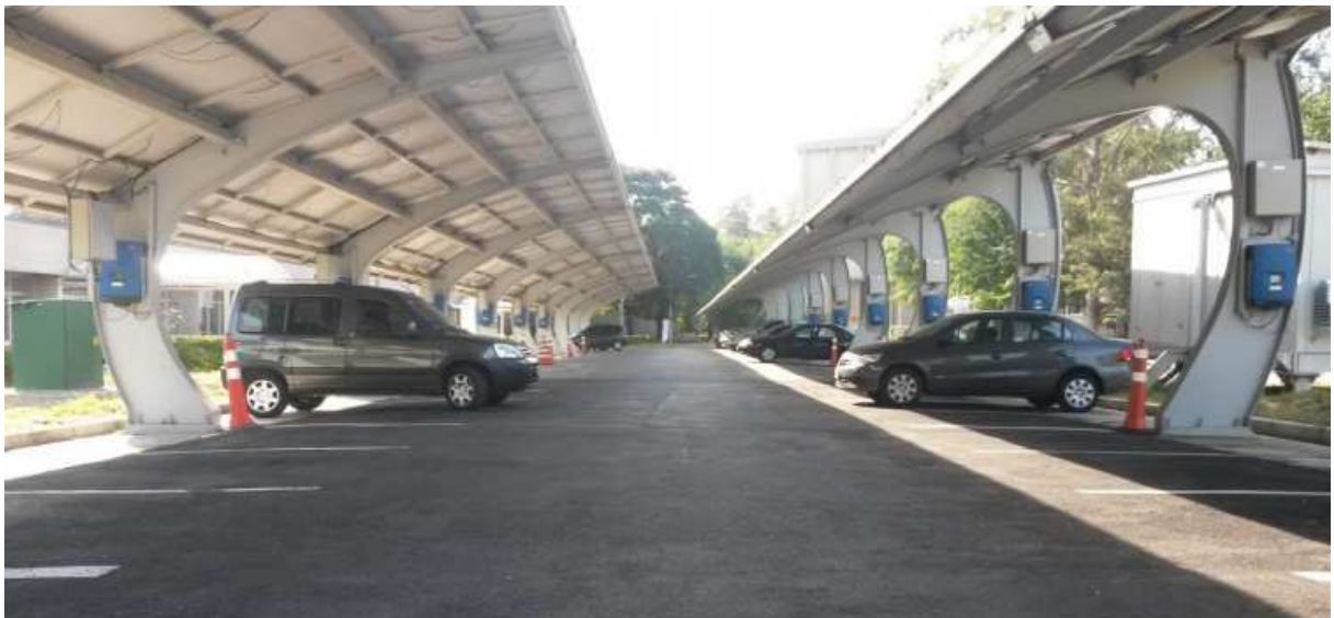
Figura 3.6 - Vista inferior do sistema BIPV
