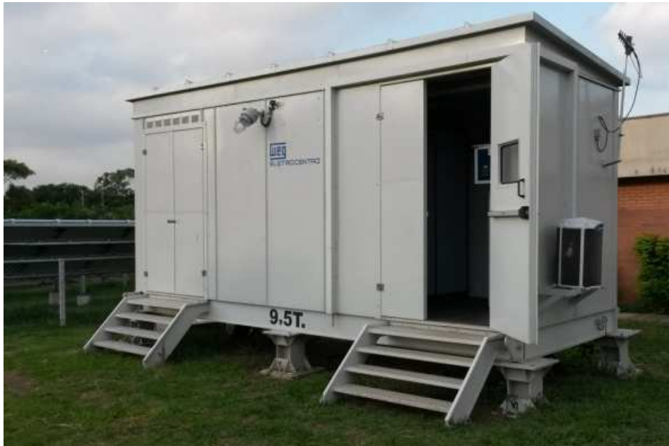
Figura 3.4 - Eletrocentro do sistema CTPV
