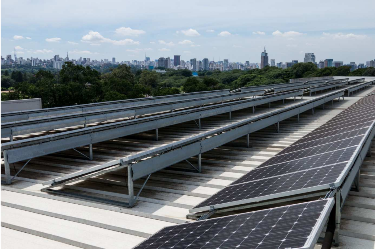
Figura 3.15 - Vista traseira da montagem dos módulos fotovoltaicos sobre o telhado
