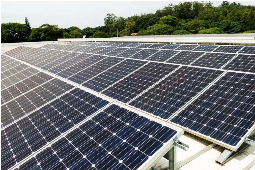
Figura 3.14 - Vista frontal da montagem dos módulos fotovoltaicos sobre o telhado.
