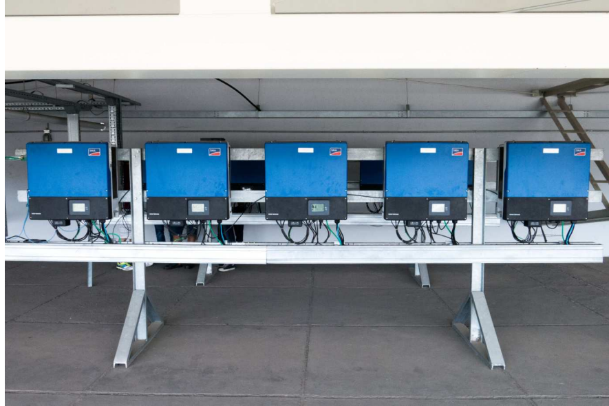
Figura 3.8 - Estrutura de montagem dos inversores da usina fotovoltaica
