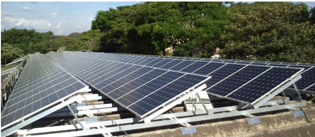
Figura 3.7 - Gerador fotovoltaico do sistema BAPV-CR
